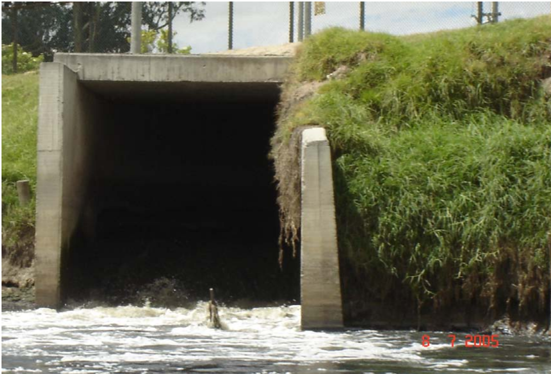
Vertimiento de la Empresa de Acueducto y Alcantarillado de Bogotá (EAAB), sin ningún tratamiento, al río Bogotá.
